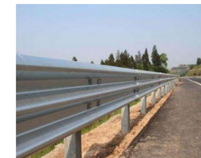
公路护栏 Guard Rail
