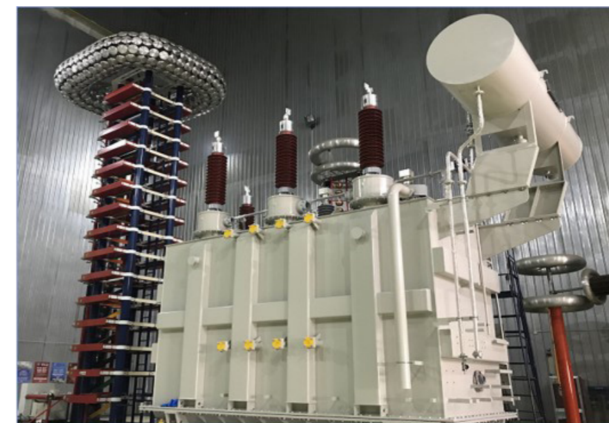
唐山某环保项目 1 级能效电力变压器 SFSZ-135000/110
