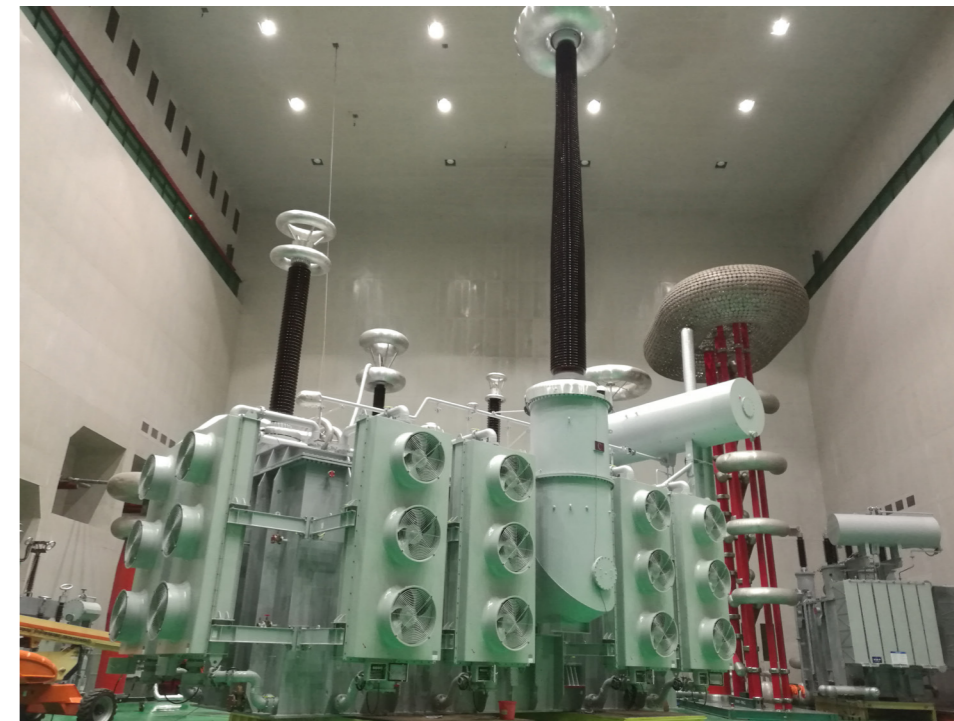
淮南 - 上海特高压工程苏州站 ODFPS-1000000/1000
