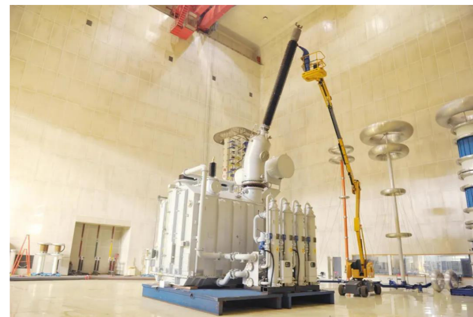
白鹤滩水电站 DSP-375000/500
