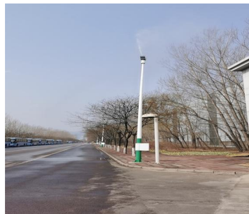
迁钢公司雾桩抑尘装置
