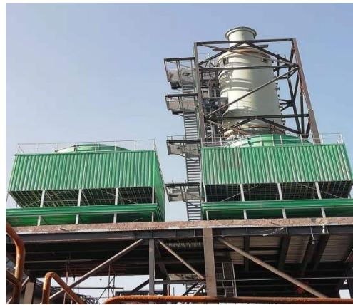
迁钢公司高炉冲渣水消白治理
